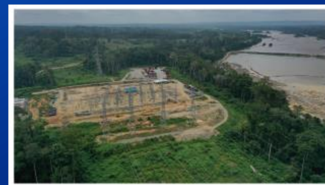
Poste et Ligne 225kV
