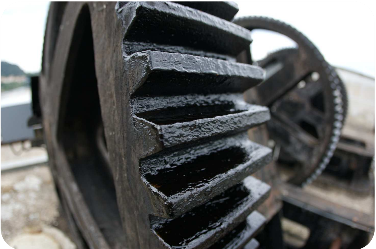
Barrage de Beaumont Montoux, détail de machinerie des vannes, roue dentée © EDF – Franck ODDOUX
