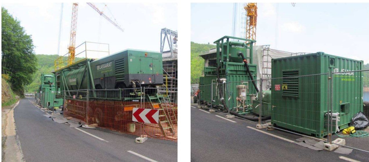
Figure 20 : Vue d'une partie des installations de chantier pour les opérations de désamiantage sur l'EVC2
