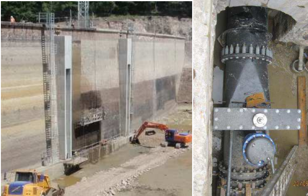
Graphique 2 : Puits de vidange de fond et chambre de manœuvre aval (travaux en cours)
