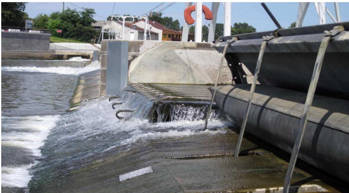
Figure 14 : barrage d'Auxonne, incident du 25 juillet 2011 [crédit image ©Voies Navigables de France]
