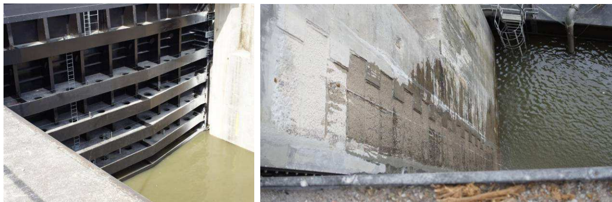
Graphique 15 : Mise en eau et constat de fuites à l'aval de la porte à travers les bajoyers
