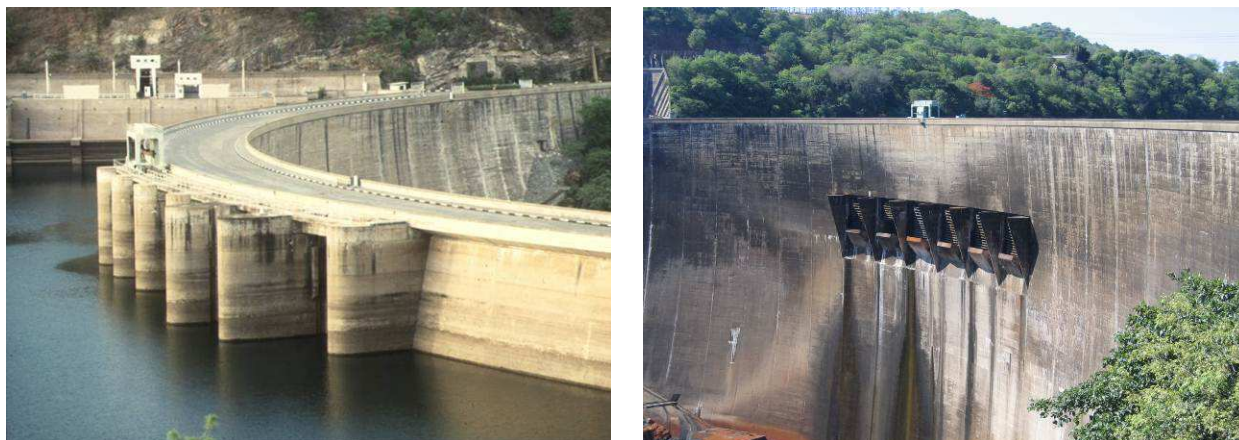
Figure 1 : Evacuateur vu d'amont, plan d'eau proche du minimum d'exploitation (à gauche) ; vu d'aval (à droite).
