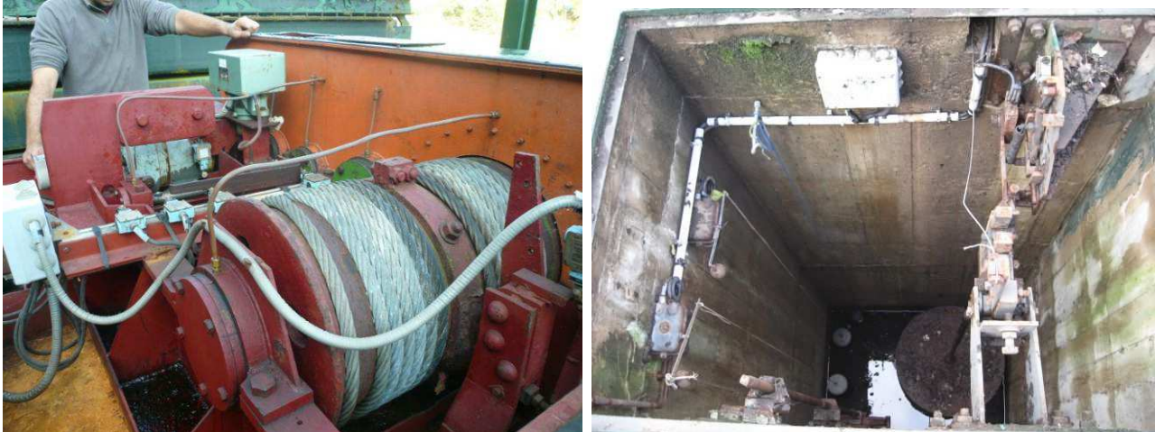
Graphique 8 : Treuil électrique de manœuvre et système d'automatisme avec flotteur
