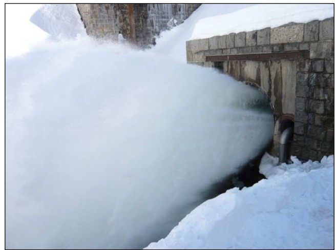
Figure 4.b : Vue aval de la vanne de fond de Gnioure à ouverture partielle ( \theta=50^\circ )
