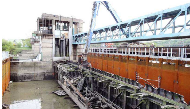
Photo 5: Déconstruction de la vanne existante après que l'Entreprise ait pris possession de la passe
