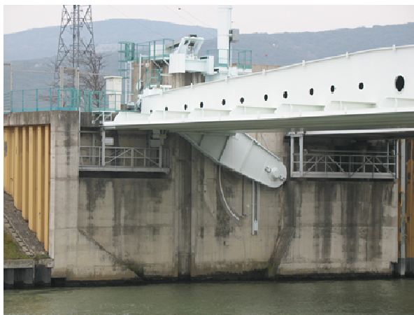
Figure 2 : Vue de la vanne NPN ouverte depuis la rive droite (avant travaux)
