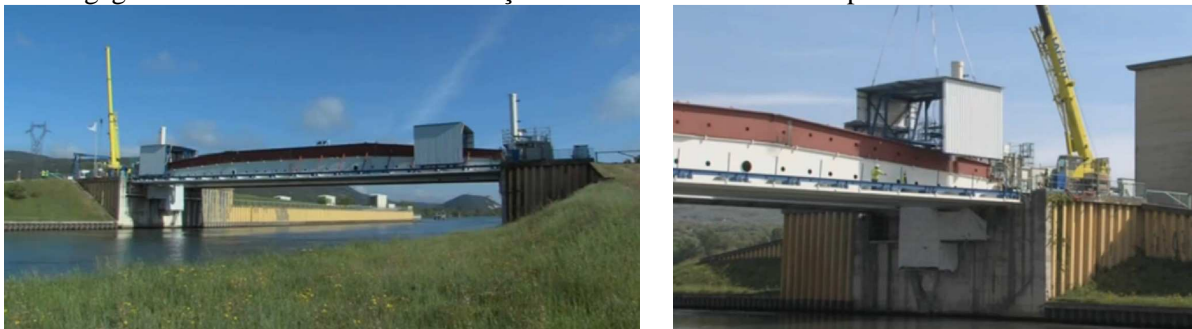
Figure 14 : Configuration de la vanne en phase soudage (présence de 2 portiques et 2 abris de soudage). Une grue mobile présente sur site permet à tout moment le retrait des abris de soudage
