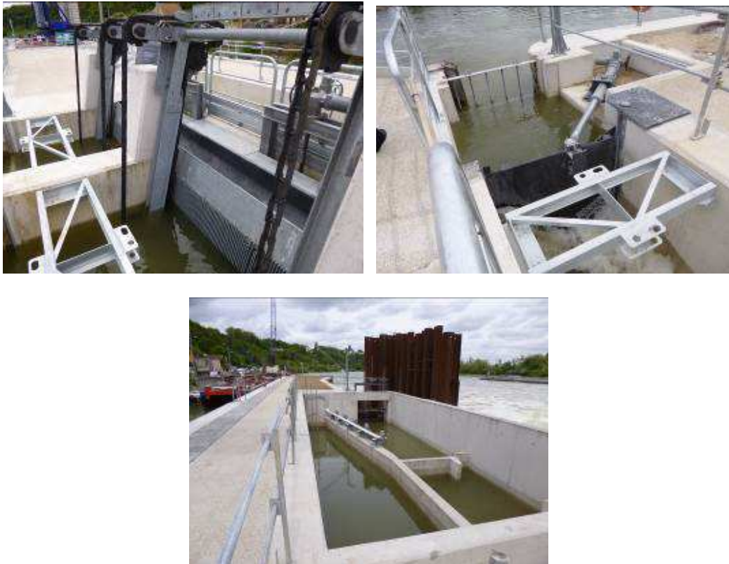
Figure 2 : Dégrilleur du débit d'attrait de la passe à poisson, Vanne d'isolement de la passe à poisson et Vue coté amont de la passe à poisson ; vanne de régulation et grilles rotatives du débit d'attrait
