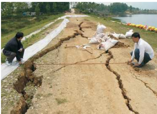
Figure 8-5 – Séisme de Wenchuan (photo M. Wieland)
