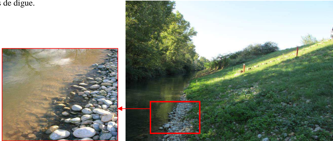
Figure 6 : Vue d'une des zones de digue présentant de la suffusion en pied de digue, PK 94.2 RG
