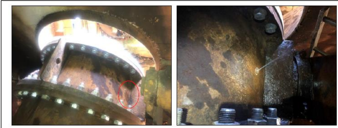
Figure 4 : Fuite sur la perforation du corps de la vanne papillon
