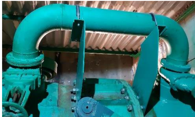
Figure 25- Vue d'ensemble du circuit by-pass renforcé
