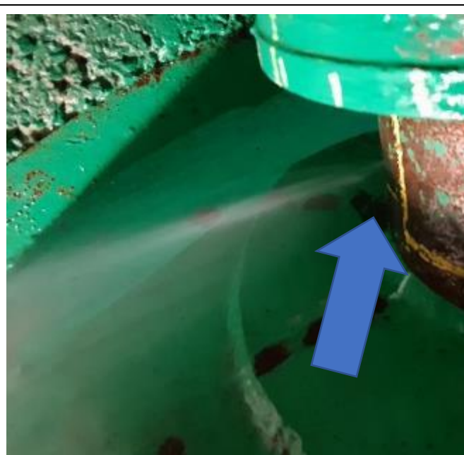
Figure 6-Vue de la fuite du piquage amont
