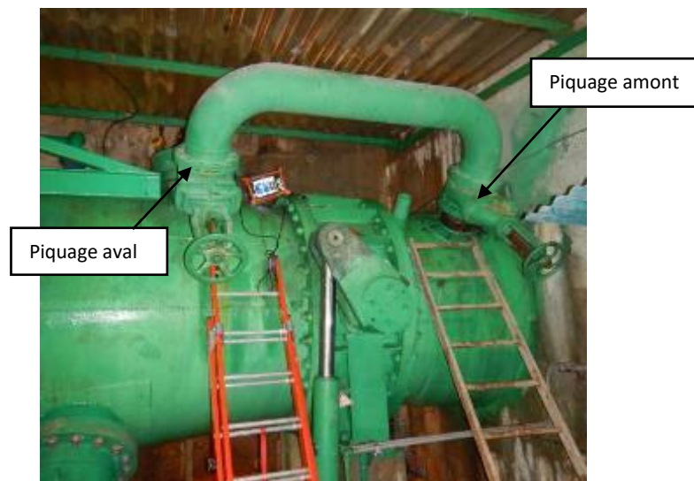
Figure 3 - vue d'ensemble de la vanne de tête galerie et de son by-pass
