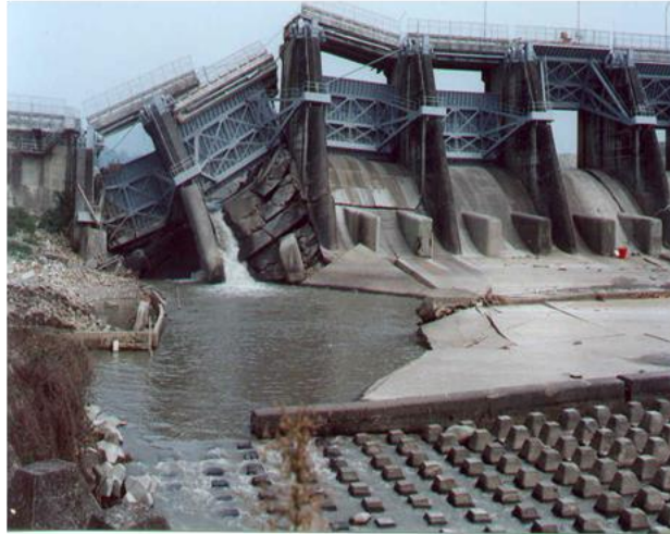
Figure 1 : Le séisme de Chi-Chi (1999 Mw = 7.9) à Taïwan détruit plusieurs passes du barrage de Shih-Kang par rejet de faille et tassements différentiels des passes du barrage en rivière. Les vannes (mais pas les passes) ont plutôt bien résisté à l'évènement.
