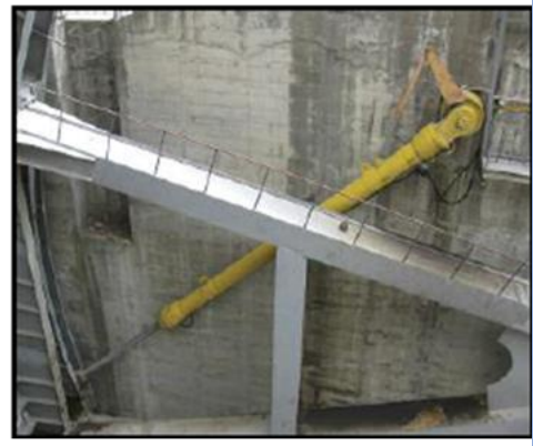
Figure 3 : vérin avant le séisme
