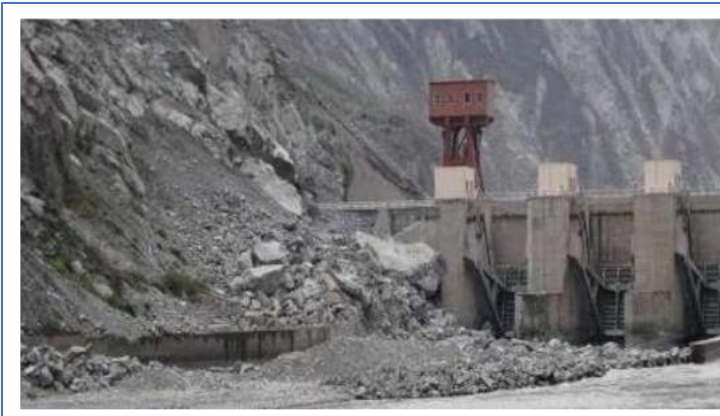
Figure 2 : Eboulement rocheux devant l'évacuateur
