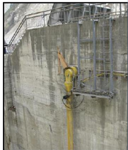
Figure 5 : Vérin coupé par une chute de bloc
