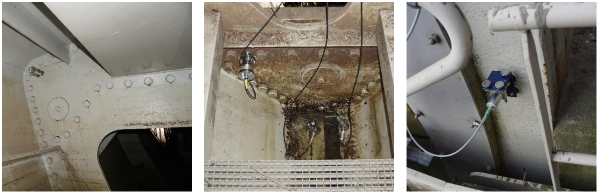
Figure 5 : Capteur d'accélération ACC1 ( \pm 12 g) en partie centrale de la vanne (à gauche); capteur d'accélération ACC2 ( \pm 12 g) sondes de pression P1 et P2 en pied de vanne (au centre); capteur à fil tendu S (à droite) 00
