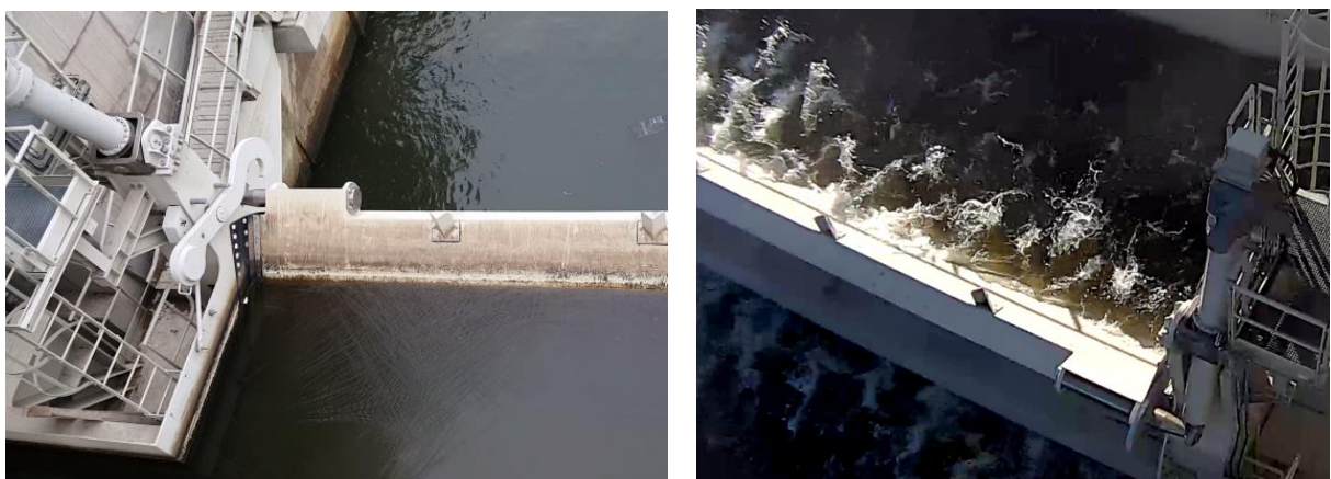
Figure 3 : à gauche constat d'un phénomène de bourdonnement à très faible ouverture, à droite vibrations de basse fréquence pour une ouverture de 30cm conduisant à une mise en résonance de la vanne segment © VNF
