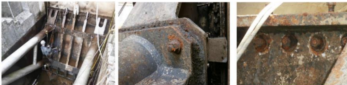
Figure 11 : Vue de la vanne lors de l'expertise
