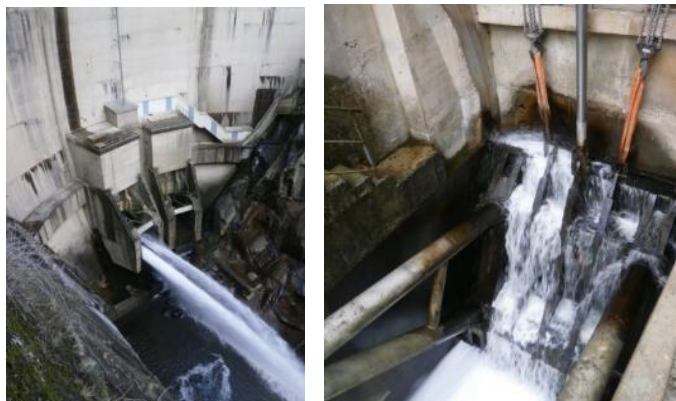
Figure 2 : Passage du débit réservé par la vanne de fond RD
