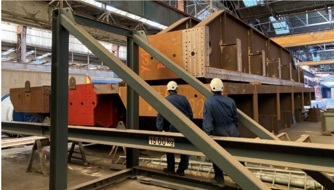
Photo 3 : les 4 éléments horizontaux de la vanne stoney chez JPSA
