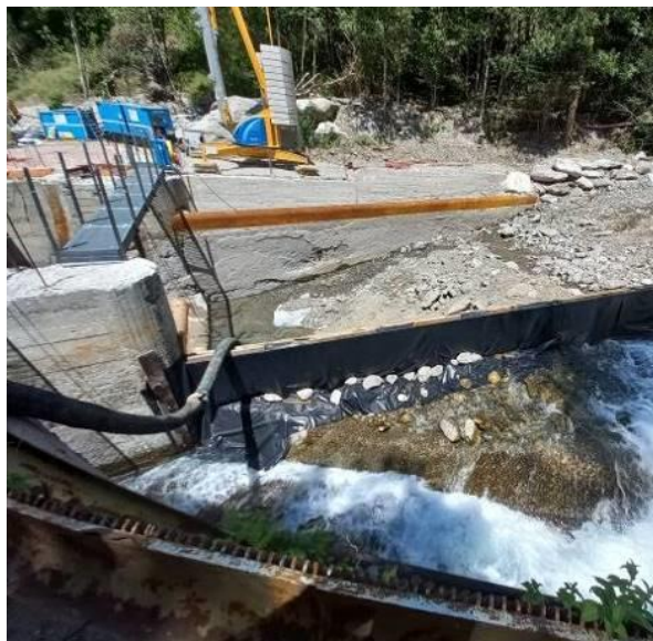
Figure 9- Vue de la mise à sec de la passe V1 depuis l'amont
