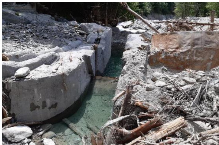
Figure 3-Vue de l'état de la vanne V1 en cours de dégravement
