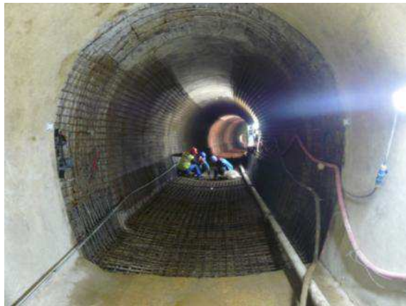
Photo 3 : Travaux de réfection de la galerie d'amenée réalisés en 2009 Profil de la galerie en « fer à cheval »
