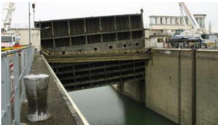
Figure 3 : Exemple d'aléas rencontré sur une porte d'écluse
