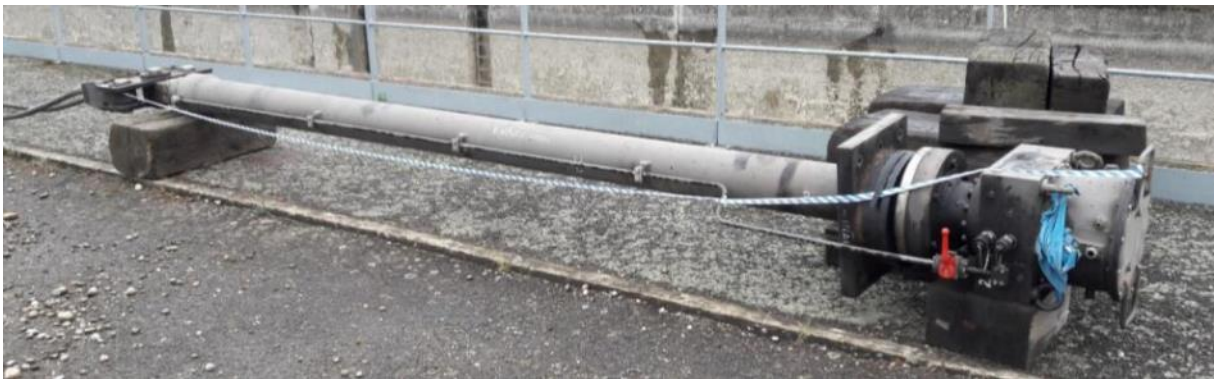
Figure 9 : Vérin de manœuvre ancienne génération déposé
