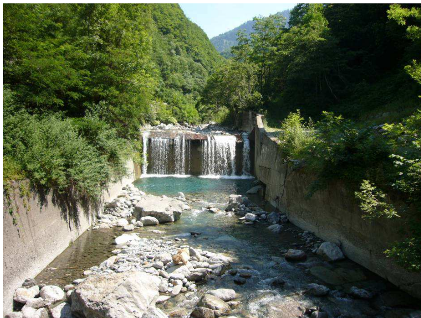
Graphique 2 : Seuil amont – bajoyer rive gauche fissuré et affaissé
