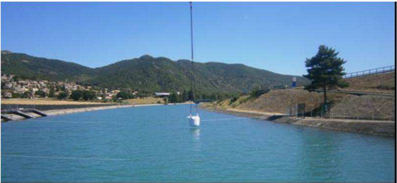
Graphique 8 : photo de la mise en place des bigs-bags par la grue à tour
