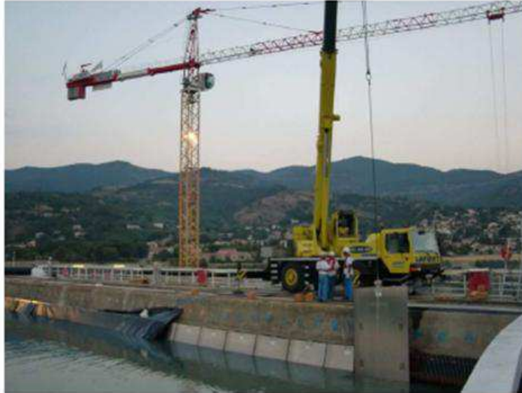
Graphique 7 : photo de la mise en place des dernières plaques et de la membrane d'étanchéité
