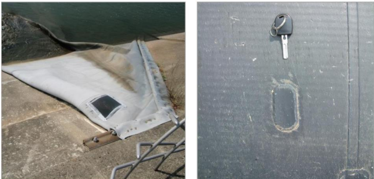
Figure 8 : exemples de réparations de petits dommages par mise en place de patches sur site © PIANC
