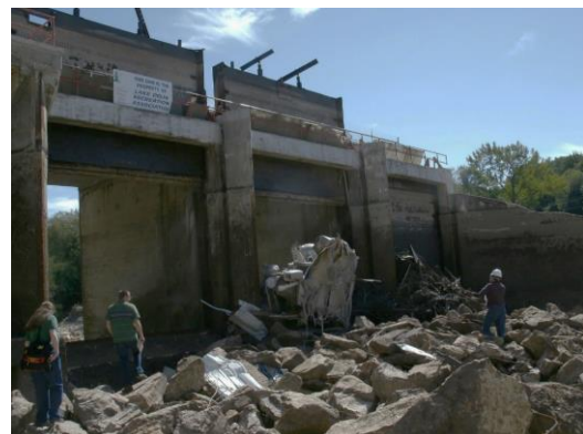
Figure 6 : Vue amont de l'évacuateur de crue du barrage du lac Delhi après rupture montrant les vannes n°1 et 2 ouvertes et la vanne n°3 en position presque fermée
