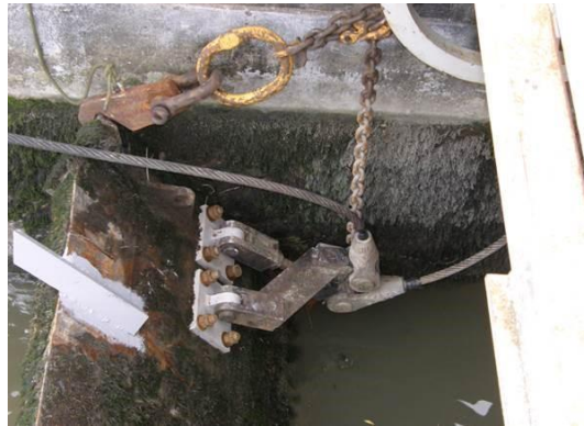
Figure 13 : Vue de détail : plaques boulonnées sur la totalité de l'épaisseur du clapet, supports des pièces d'attache
