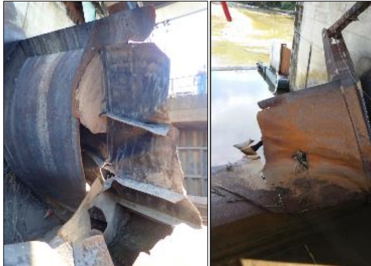
Figure 7: Vue de la rupture du clapet n°6
