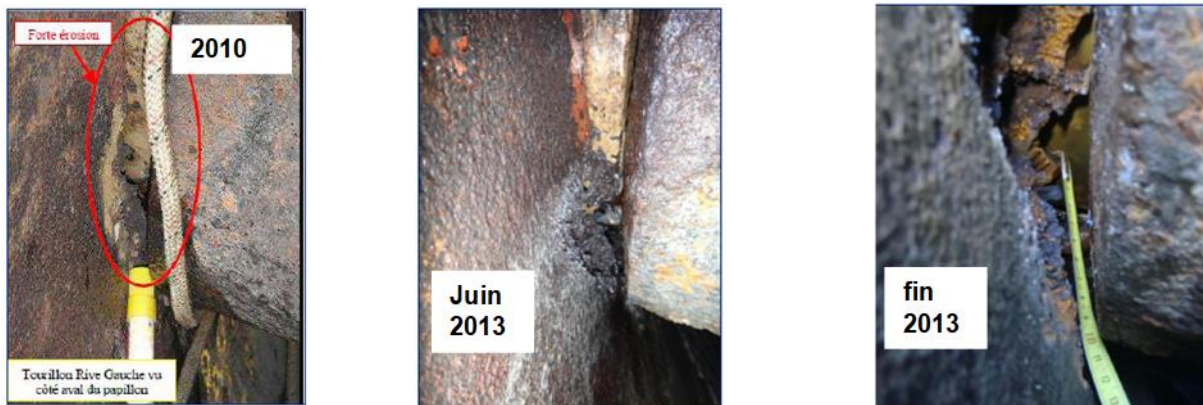
Figure 4 : évolution de la dégradation au droit du tourillon RG entre 2010 et fin 2013 (vanne d'origine RD)
