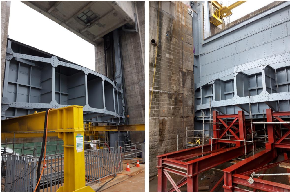
Figure 12 - Vanne supérieure et Vanne inférieure posées sur leurs appareils respectifs
