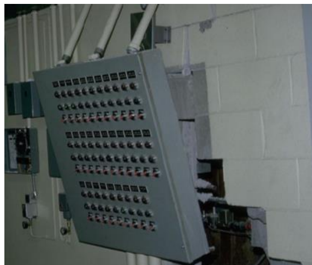
Figure 8 : Exemple d'un arrachement d'un panneau de contrôle
