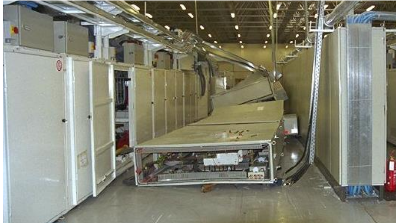
Figure 10 : Exemple d'une chute d'armoires lors d'un séisme
