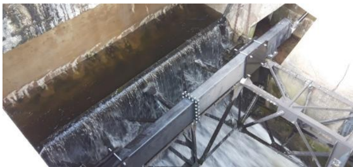
Figure 4 - vanne by-pass en cours d'ouverture
