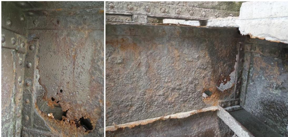
Photo 13 : Voile 4 vu depuis la RD (à gauche) et depuis la RG (à droite)
