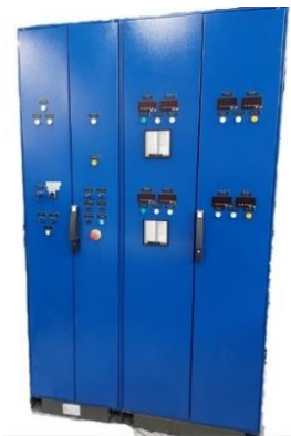
Figure 10 - Vue de l'armoire de commande locale avec les interfaces utilisateurs
